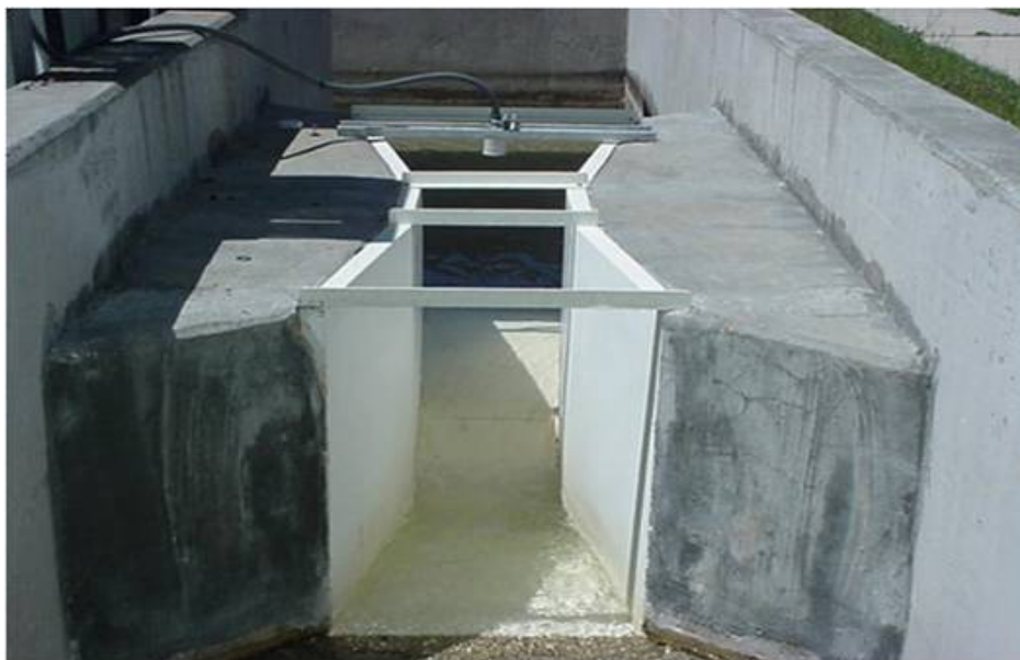
Imagen canal Parshall + sensor ultrasónico de nivel
